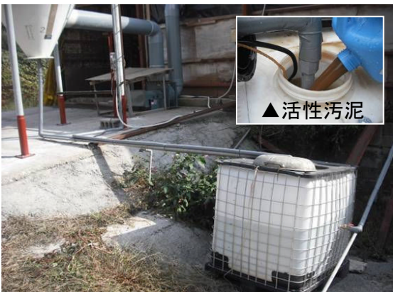
▲活性汚泥タンク
