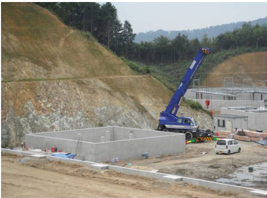
▲脱臭槽全体像
