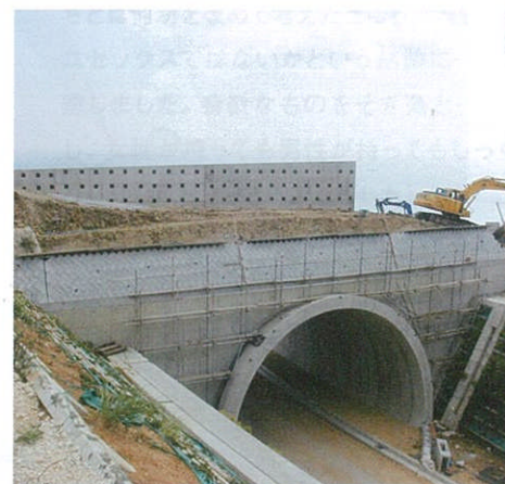
橋脚の軽量盛土材として使われている
